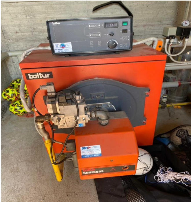
Generatore termico esistente
